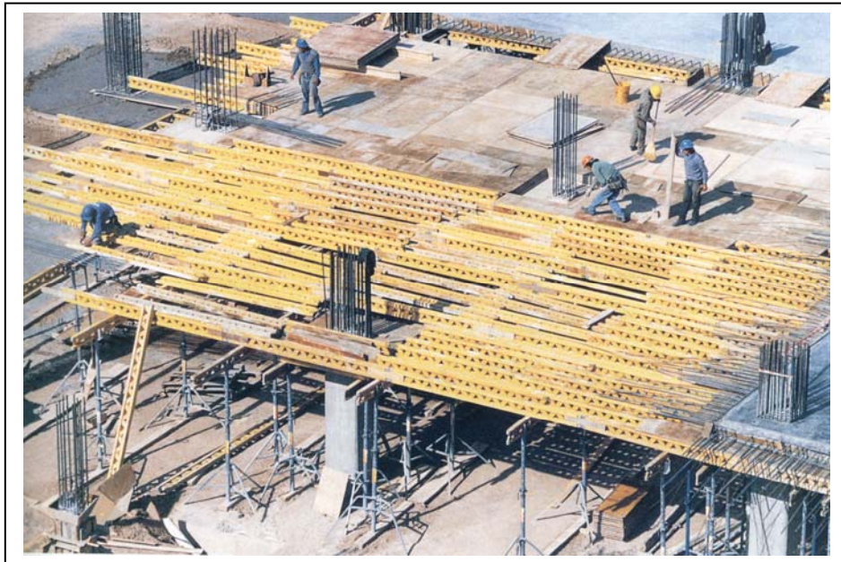
Figura 23 – Foto aérea de montagem de escoramento de laje da Peri. Em amarelo, as vigas de madeira que sustentarão a madeira compensada resinada que servirá de forma para o concreto. Sob as vigas, escoras de alumínio que sustentam a laje.
