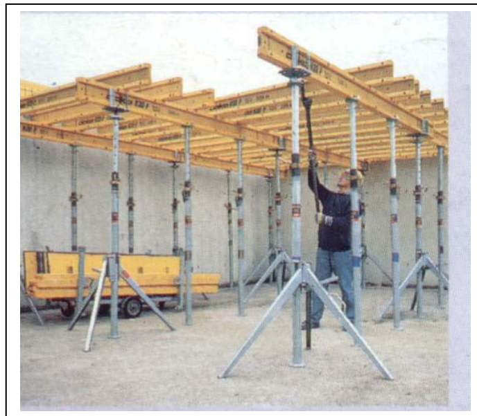
Figura 27– Aspecto de uma montagem do equipamento Doka. O escoramento vertical é realizado mediante escoras de aço, mantidas em prumo por meio de tripés, que serão removidos após a concretagem. Em amarelo, o escoramento horizontal, com vigas de madeira. Sobre elas será montada a forma de madeira compensada resinada.
