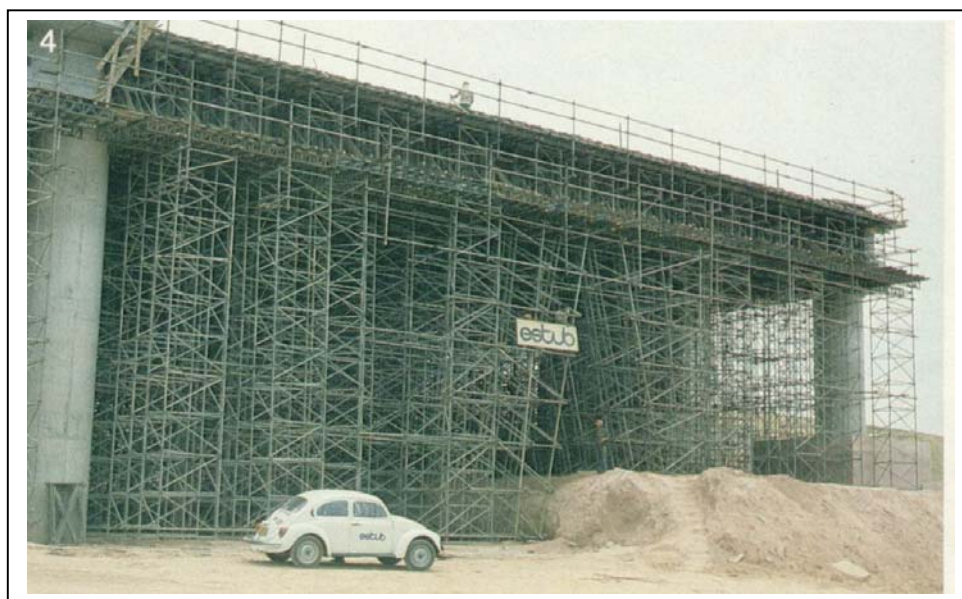
Figura 41 – Foto de escoramento da Estub realizado por meio de torres formadas por quadros tubulares no escoramento vertical e vigas de aço no escoramento horizontal. O fabricante não produz escoras nem painéis de forma mista.
