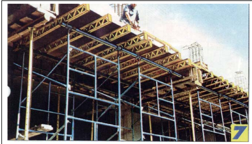
Figura 42 – Detalhe do catálogo da Gethal, mostrando um exemplo de montagem utilizando como escoramento vertical quadros tubulares superpostos, em azul e, em amarelo o escoramento horizontal, composto por vigas em treliça feitas em aço. A forma para concreto é feita com madeira compensada resinada.
